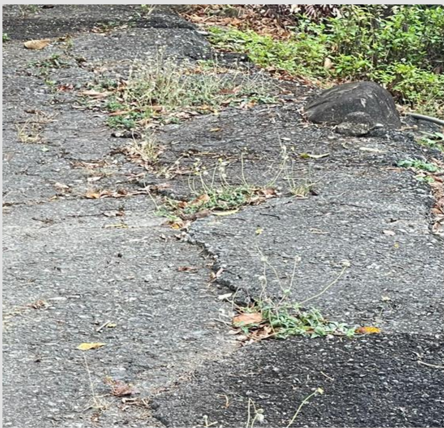
路面多處龜裂
